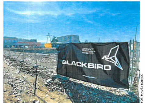
Wykop na ul. 29 Listopada. Od dawna nic tu się nie dzieje. Pojawiły się pogłoski, że to samowola
